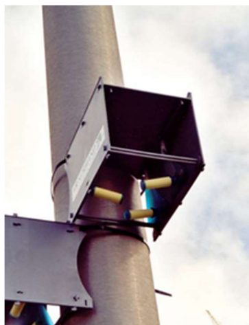
Figure 3 : Exemple de fixation des tubes à diffusion passive à l'intérieur d'une boîte de protection
