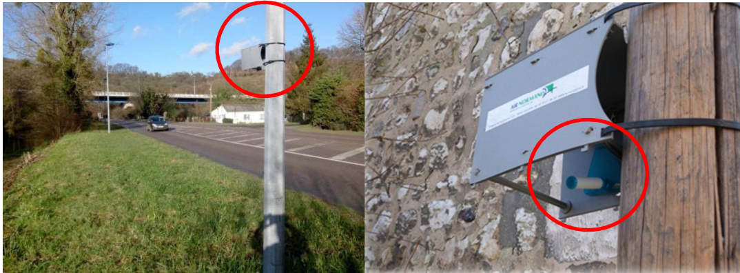
Figure 5 : exemples de l'installation sur site du système d'échantillonnage dans son abri
