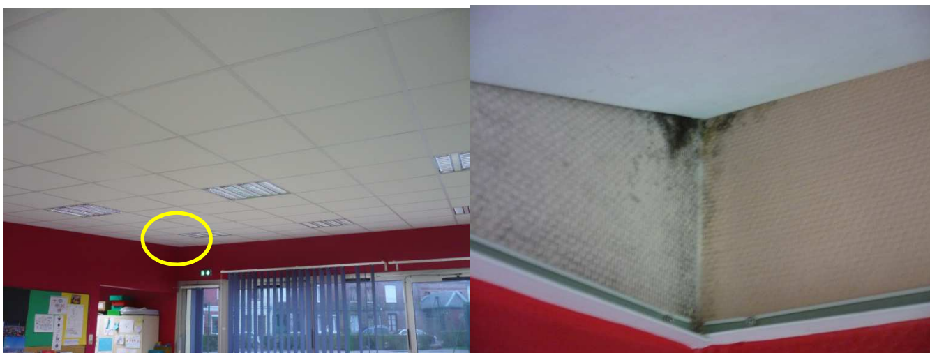
Figure 9 : site de prélèvements de surface dans la salle n° 6 (à gauche : vue d'ensemble ; à droite : zoom derrière le faux-plafond)
