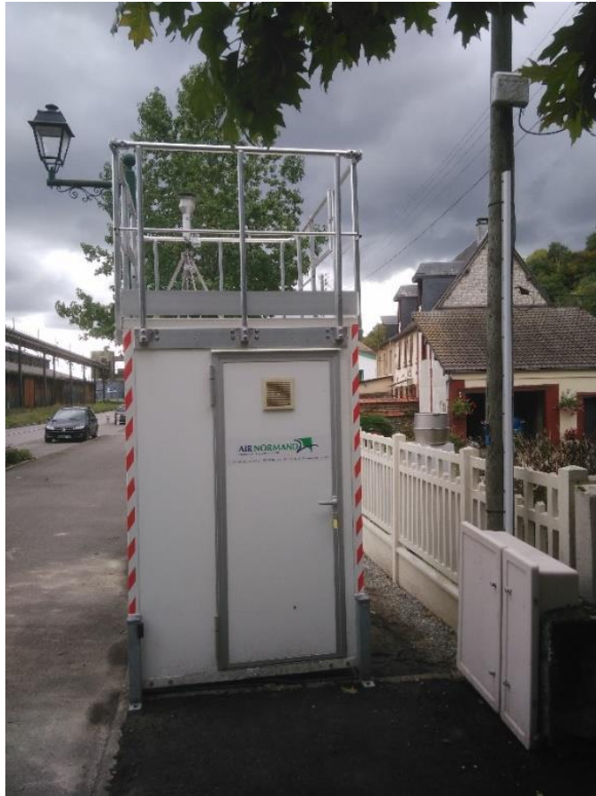
Figure 4 : Cabine de mesure à Quenneport, équipée à l'intérieur de l'analyseur TEOM-FDMS, avec sortie sur le toit d'une tête de prélèvement PM 10
