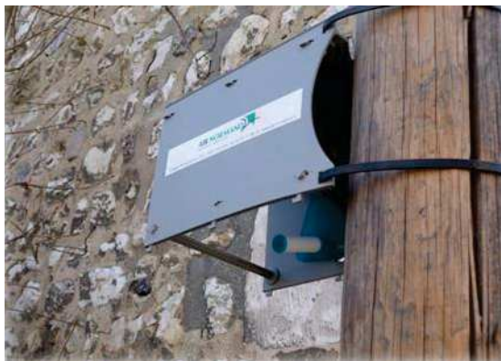
Figure 1 : tube à diffusion passive installé dans son abri de protection
